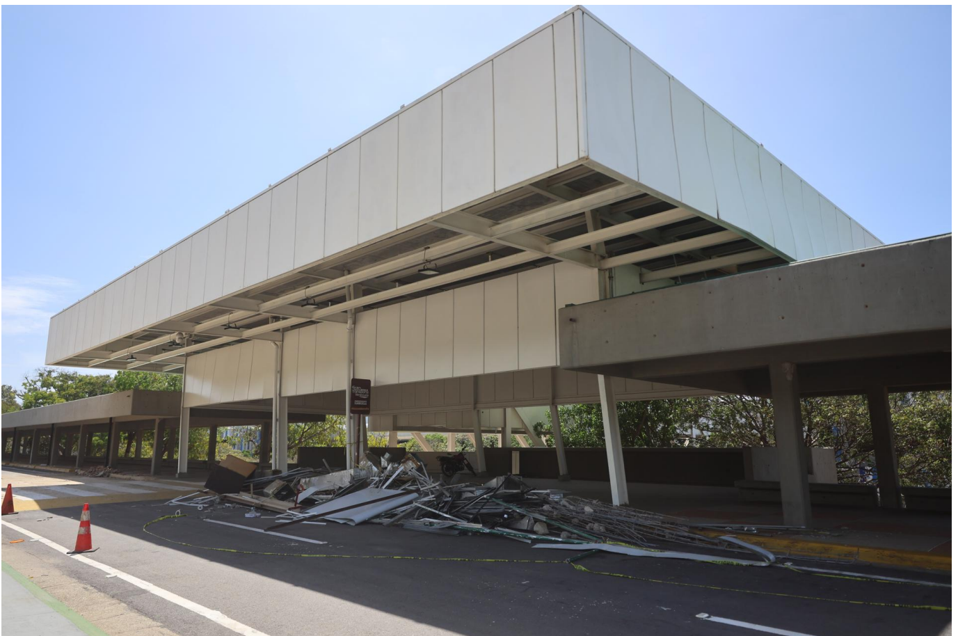
Fotografía que muestra el exterior del Aeropuerto Internacional de Maiquetía afectado por el terremoto de magnitudes 7,2 y 7,5, este miércoles, en Maiquetía (Venezuela). EFE/ Miguel Gutiérrez
