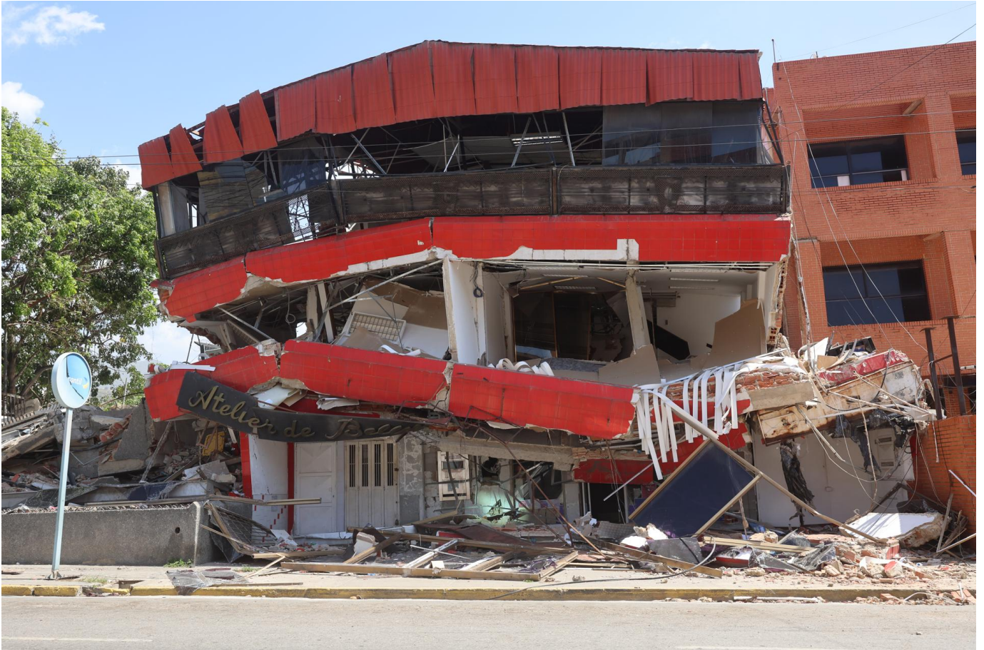
Fotografía que muestra una casa afectada por el doble terremoto de magnitudes 7,2 y 7,5, este miércoles, en La Guaira (Venezuela). EFE/ Miguel Gutiérrez
