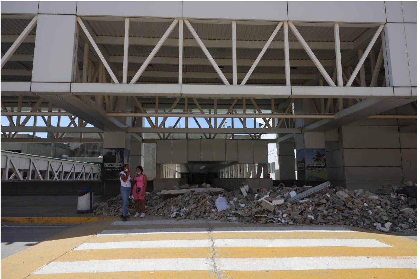
Fotografía que muestra el exterior del Aeropuerto Internacional de Maiquetía afectado por el terremoto de magnitudes 7,2 y 7,5, este miércoles, en Maiquetía (Venezuela). EFE/ Miguel Gutiérrez
