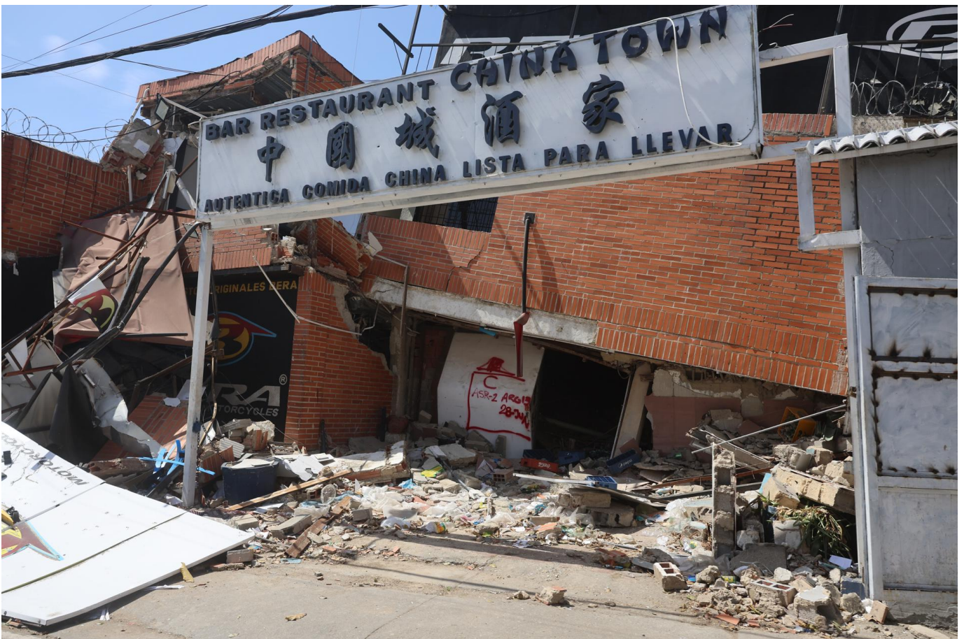
Fotografía que muestra un restaurante chino afectado por el doble terremoto de magnitudes 7,2 y 7,5, este miércoles, en La Guaira (Venezuela). EFE/ Miguel Gutiérrez
