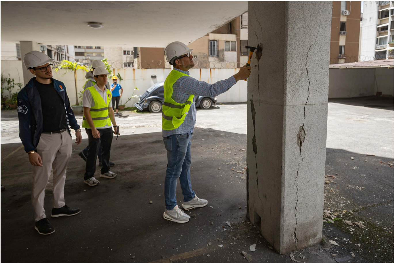
AME346. CARACAS (VENEZUELA), 18/07/2026.- Fotografía del 15 de julio de 2026 que muestra a ingenieros realizando una inspección en un edificio afectado por los dos terremotos en Caracas (Venezuela). Cuando Betzi Gutiérrez se calza sus botas y viste su chaleco amarillo y casco blanco de ingeniera para revisar las bases de los edificios afectados por el doble terremoto, ocurrido en la zona norte de Venezuela, no solo carga con las herramientas y la responsabilidad de su profesión; también lleva el peso de haber visto su propio techo desplomado el pasado 24 de junio. EFE/ Ronald Peña R
