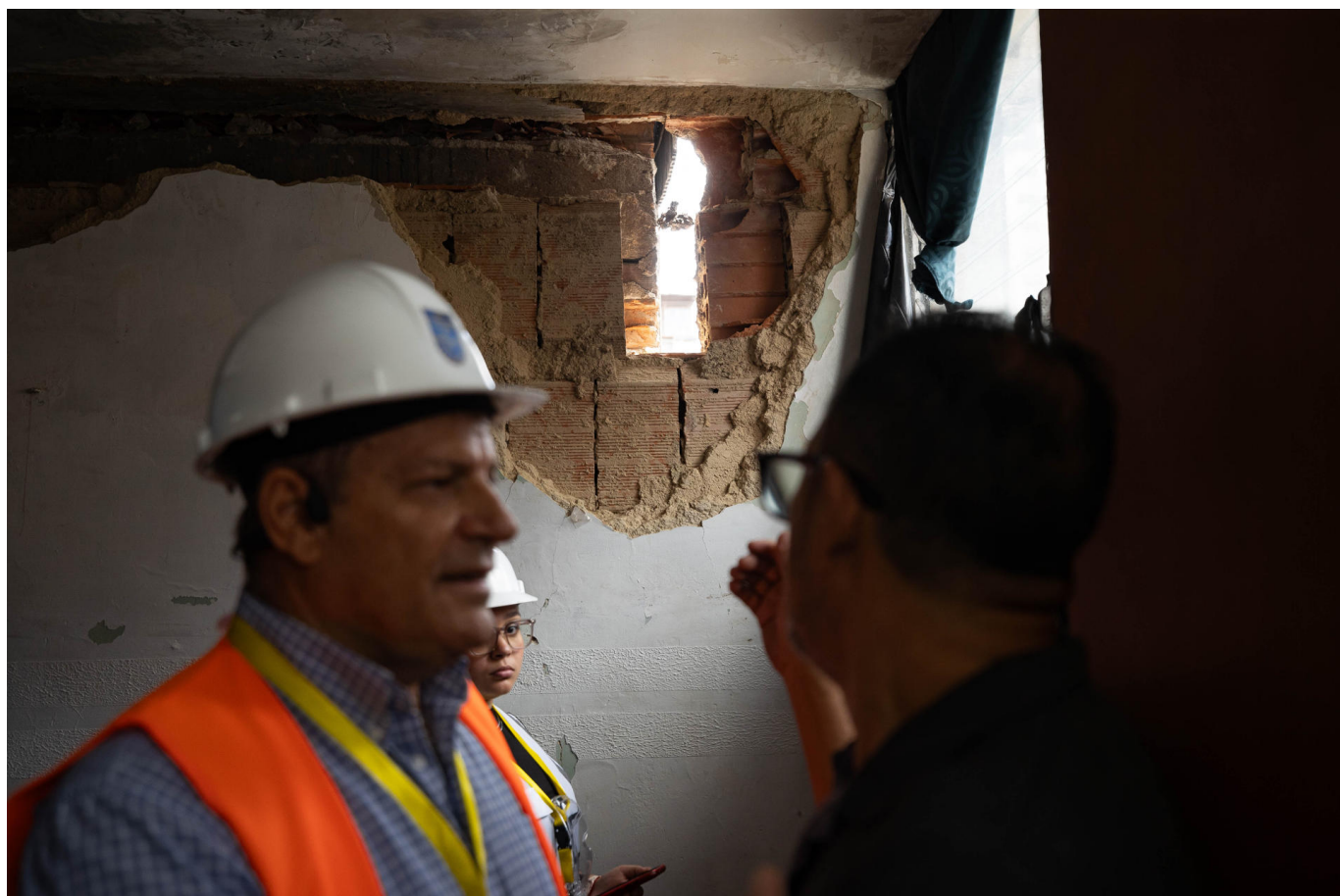
AME348. CARACAS (VENEZUELA), 18/07/2026.- Fotografía del 14 de julio del 2026 que muestra ingenieros frente a una pared destruida en un edificio afectado por los dos terremotos en
