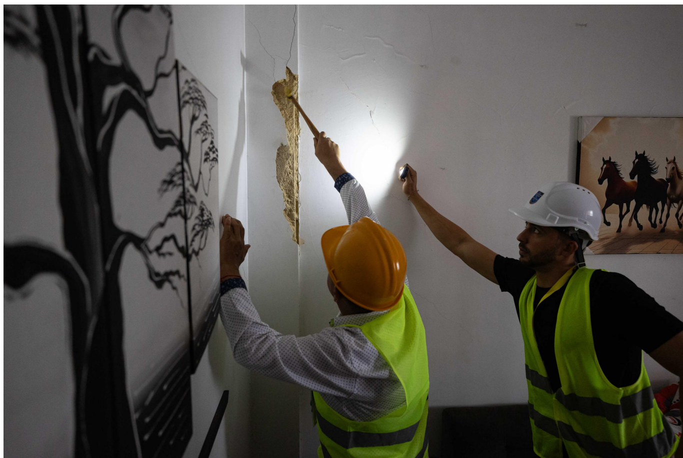
AME338. CARACAS (VENEZUELA), 18/07/2026.- Fotografía del 15 de julio de 2026 que muestra a ingenieros inspeccionando un edificio afectado por los dos terremotos en Caracas (Venezuela). Cuando Betzi Gutiérrez se calza sus botas y viste su chaleco amarillo y casco blanco de ingeniera para revisar las bases de los edificios afectados por el doble terremoto, ocurrido en la zona norte de Venezuela, no solo carga con las herramientas y la responsabilidad de su profesión; también lleva el peso de haber visto su propio techo desplomado el pasado 24 de junio. EFE/Ronald Peña R
