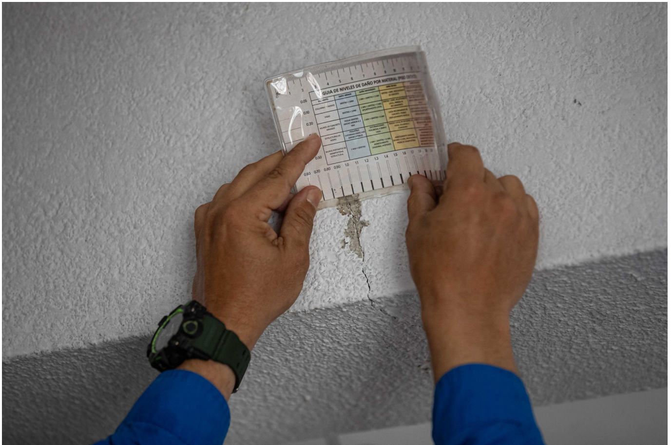
AME350. CARACAS (VENEZUELA), 18/07/2026.- Fotografía del 14 de julio de 2026 que muestra a un ingeniero midiendo una grieta durante una inspección en edificios afectados por los dos terremotos en Caracas (Venezuela). Cuando Betzi Gutiérrez se calza sus botas y viste su chaleco amarillo y casco blanco de ingeniera para revisar las bases de los edificios afectados por el doble terremoto, ocurrido en la zona norte de Venezuela, no solo carga con las herramientas y la responsabilidad de su profesión; también lleva el peso de haber visto su propio techo desplomado el pasado 24 de junio. EFE/ Ronald Peña R
