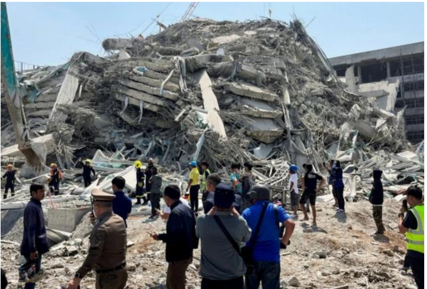
Imagen del edificio en construcción que se derrumbó en Tailandia.
