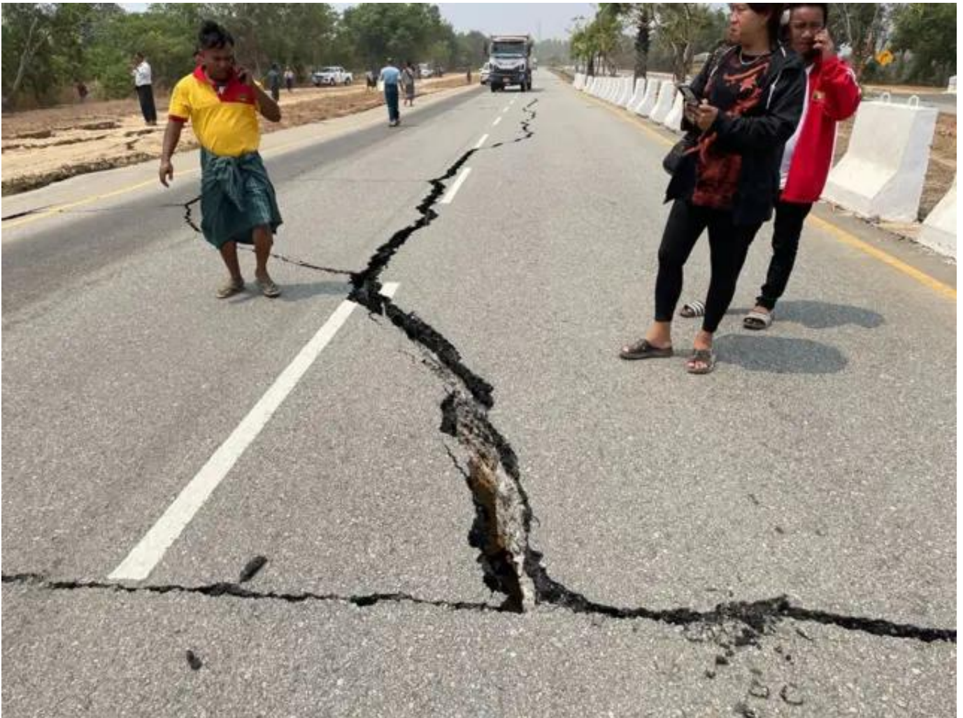
Hay reportes de fuertes afectaciones a la infraestructura del país entre ellas las carreteras.
