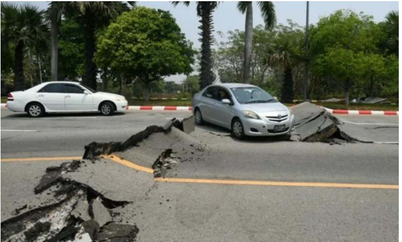
Así quedó una carretera en la capital de Myanmar.
