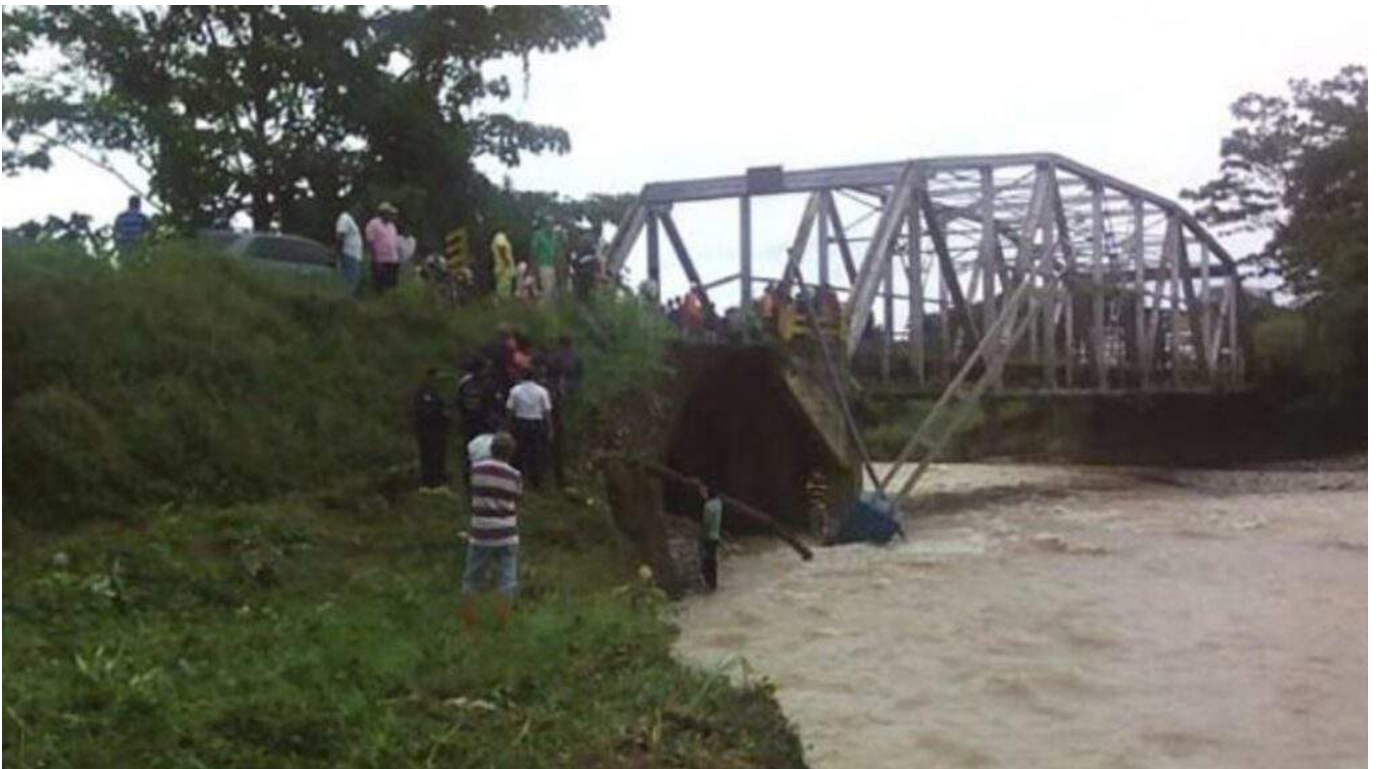
Puente sobre el río Michay afectado. Foto: Cortesía.
