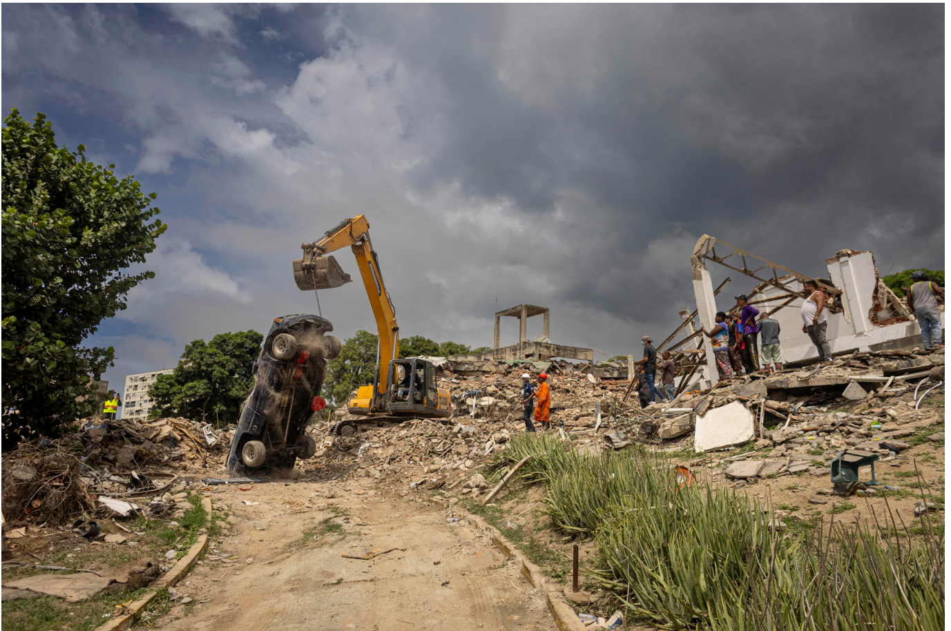
Fotografía que muestra un vehículo y edificios afectados tras los terremotos del 24 de junio, este lunes, en La Guaira (Venezuela). EFE/ Miguel Gutiérrez
